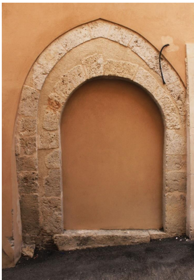
Fig.3.1.2.5 – il caso singolare del portale P1_827 in Via Accursio, in cui all'interno del fornice a sesto acuto si apre un ulteriore fornice a pieno sesto.
