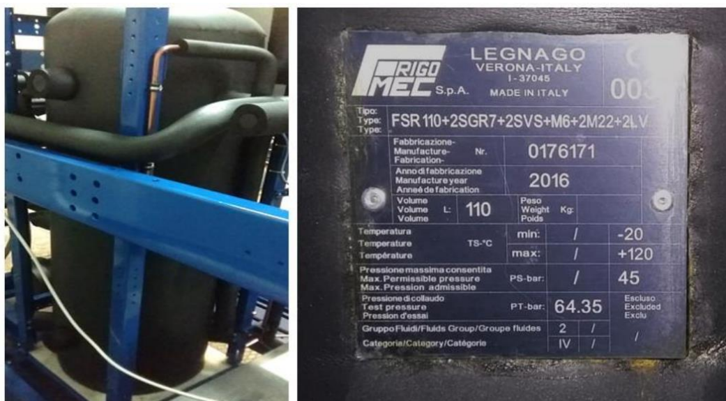
Figura 38. a) Serbatoio ricevitore dell'impianto sperimentale; b) Targa di produzione
