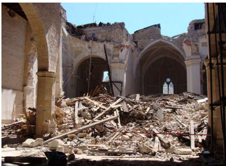
Figure 1.3 Santa Maria di Collemaggio: the post-earthquake collapse (2009).
